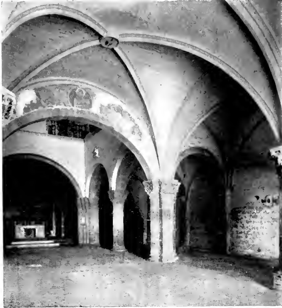
Fig. 426 — Chiesa di San Flaviano in Montefiascone - Veduta del loggiato inferiore (sec. XI e sec. XIV)
